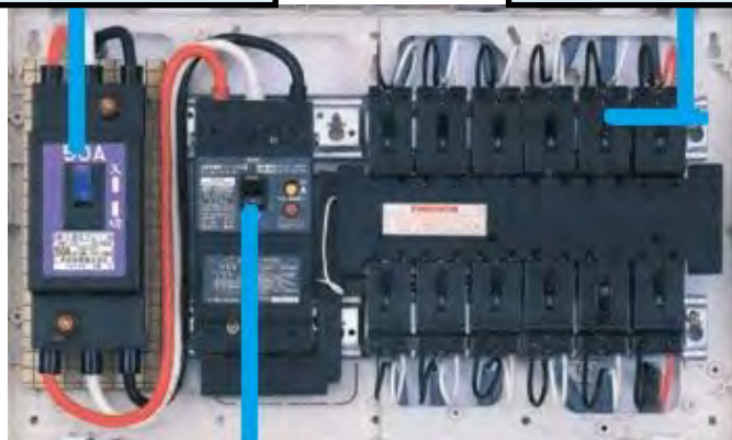
漏電用ブレーカー
